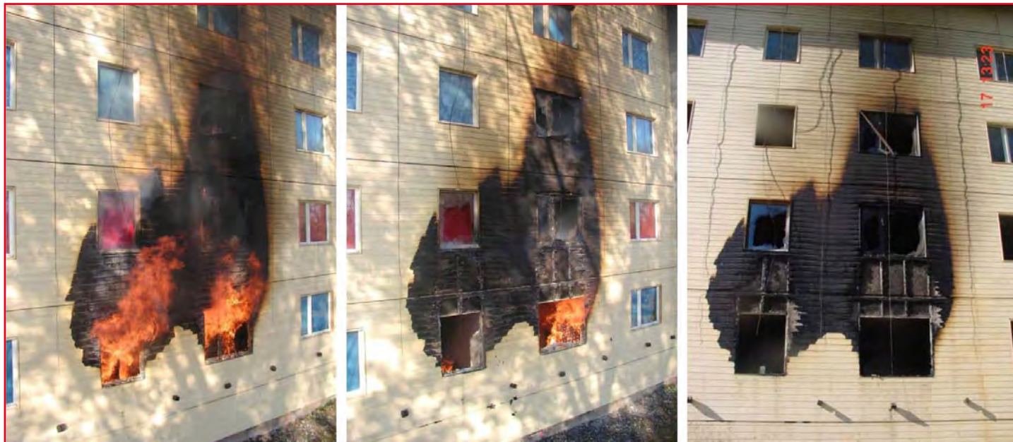
Naturbrandversuch V2 – Versuchsverlauf 32. Prüfminute 26. Prüfminute: Lokales Brennen
