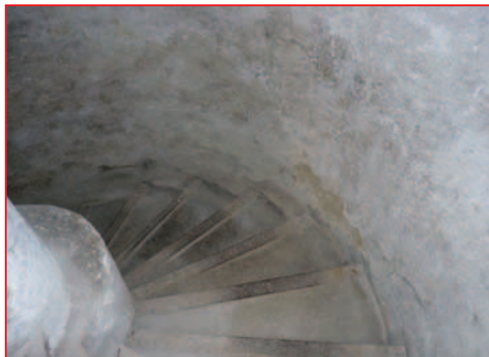
Kellertreppe ohne Handlauf
