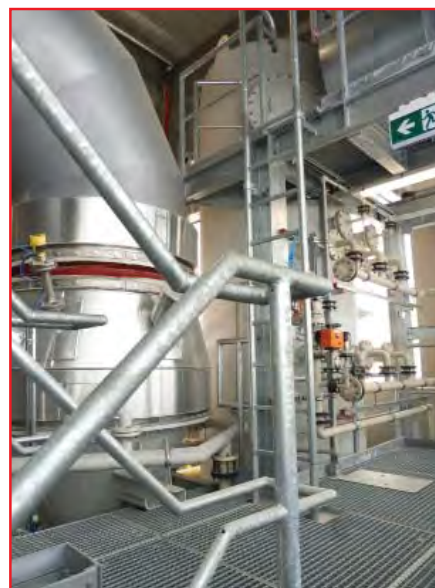
Bild 10 (Quelle MA 39): Rauchgaswäsche mit Sprühurm
