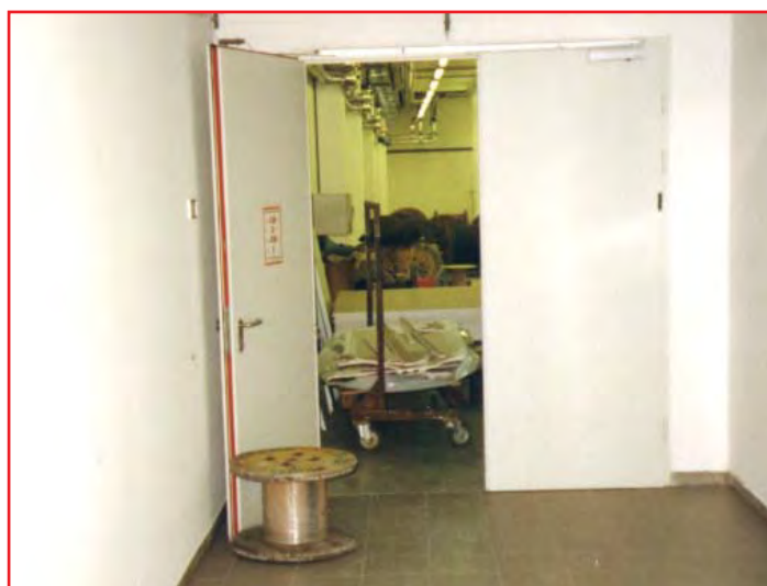
Nichtwissen? Ignoranz? Eine schon lange bekannte "Schnittstelle" zwischen Bauplanung und tatsächlichem Betrieb.
