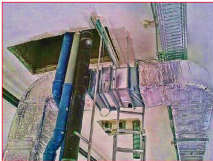
Bild 2: Koordination Architektur, Trockenbau, Lüftungsanlage mit Brandschutzklappen, HKLS, Elektroplaner und Brandfallsteuerung????
