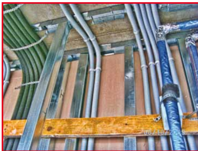
Bild 1: Ob diese Trockenbauwand nach Verschluss wohl die brandschutztechnische Klassifizierung EI 90 erfüllen wird?
