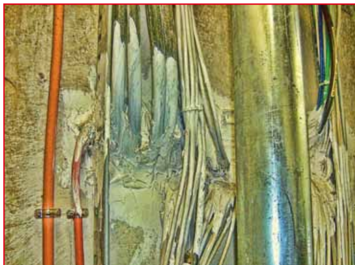
Bild 6: Beispiel für unkoordinierte Planung und absolut mangelhafte Ausführung, vermeidbar durch Begleitung der Ausführungsplanung und der Errichtung
