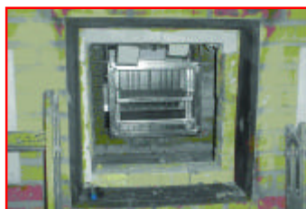
Blick auf die Brandschutzklappe im geöffneten Zustand von der Brandkammer aus
