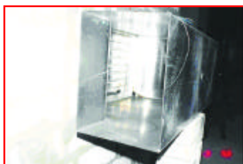
Große, rechteckige Brandschutzklappe mit T-Stück gemäß ÖNORM M 7625 auf der brandabgekehrten Seite
